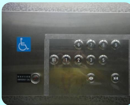
無障礙設施-電梯 (內有緊急呼叫鈴)
